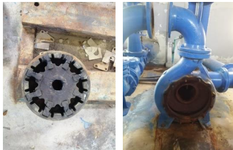
الشكل رقم (1): مضخات دفع الماء / مشروع ماء الديوانية القديم.
